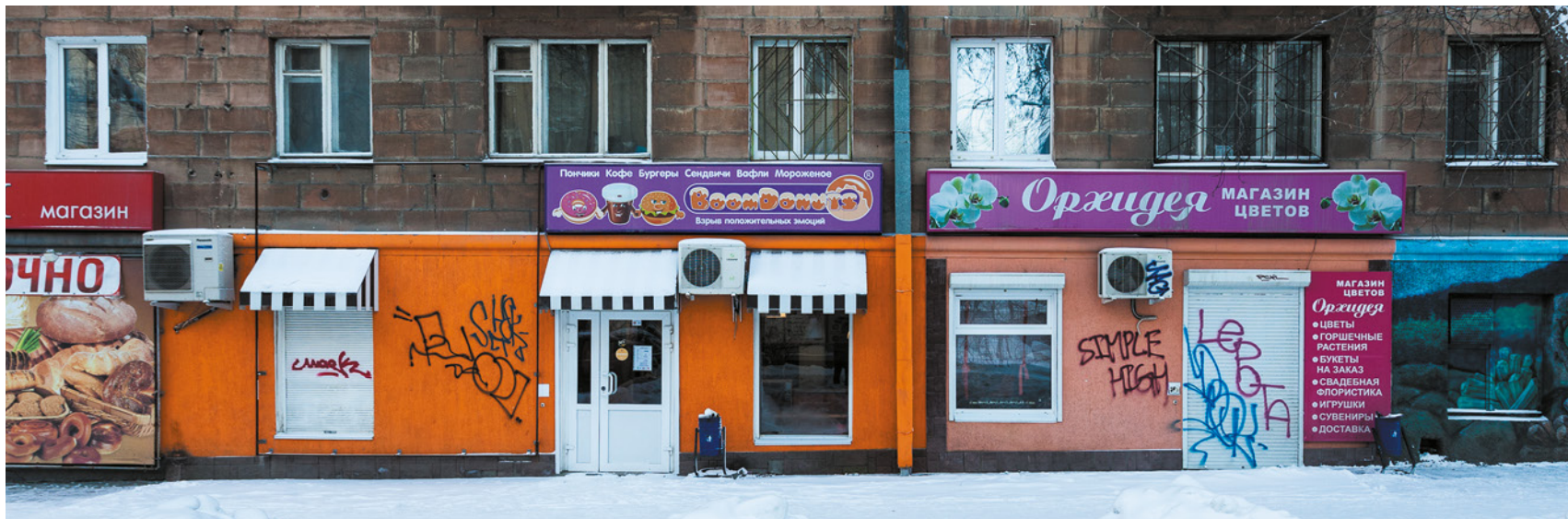
Фрагментарная окраска фасада
